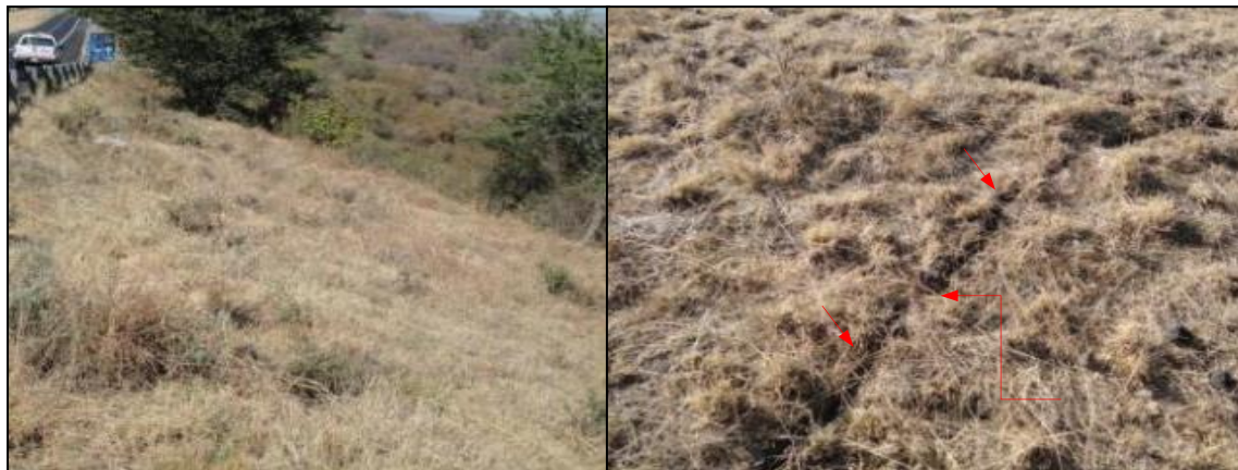
Imagen 5.1. Talud del terraplén Km. 430+650.
